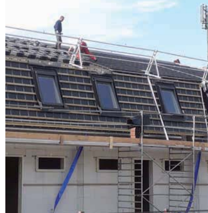
Mede door het droge weer en de strakke planning nam het dakdekken ongeveer een maand in beslag.
